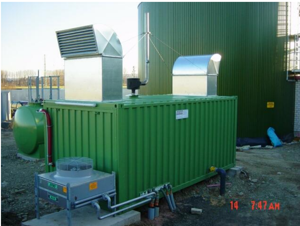
Bild 4: BHKW vor Fermenter
